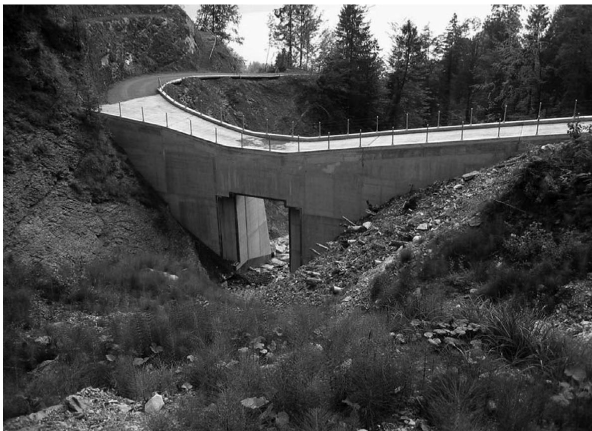
Fig. 1: Barrage filtrant en béton armé à l'aval immédiat de la zone instable à Hinter Ritzgraben.
