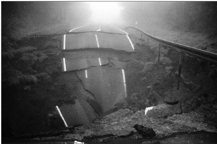
Fig. 9: Nachbruch des Erdfalles auf der B 180 im Oktober 2001 mit vollständiger Zerstörung der Fahrbahn (Foto: Dauterstedt).
